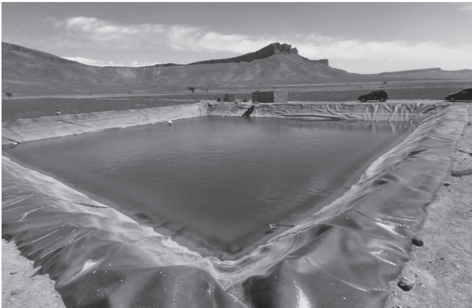
Afb. 4: Een waterbassin dat gebruikt wordt om het opgepompte water in op te slaan. Foto: Hassan Er-rayhany
